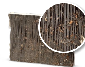
Sin mantenimiento del sistema de A/A
